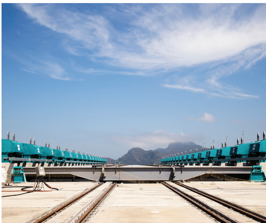
O elevador de navios e submarinos está pronto e deverá começar a funcionar neste ano, assim como alguns berços de atracação dos cais principal e auxiliar
